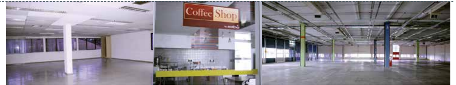
Antiga fábrica da Siemens, a sede Neville ainda não tem estrutura para abrigar atividades acadêmicas
